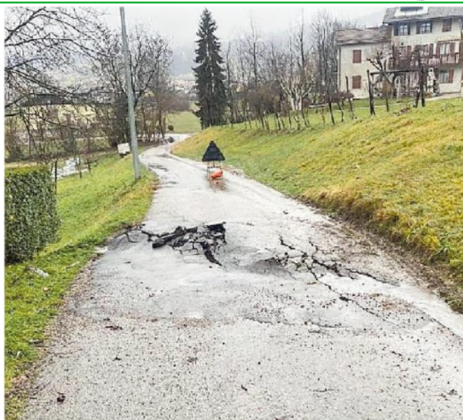
I problemi causati dal maltempo del 2020 in via Remuglia a Pedavena
