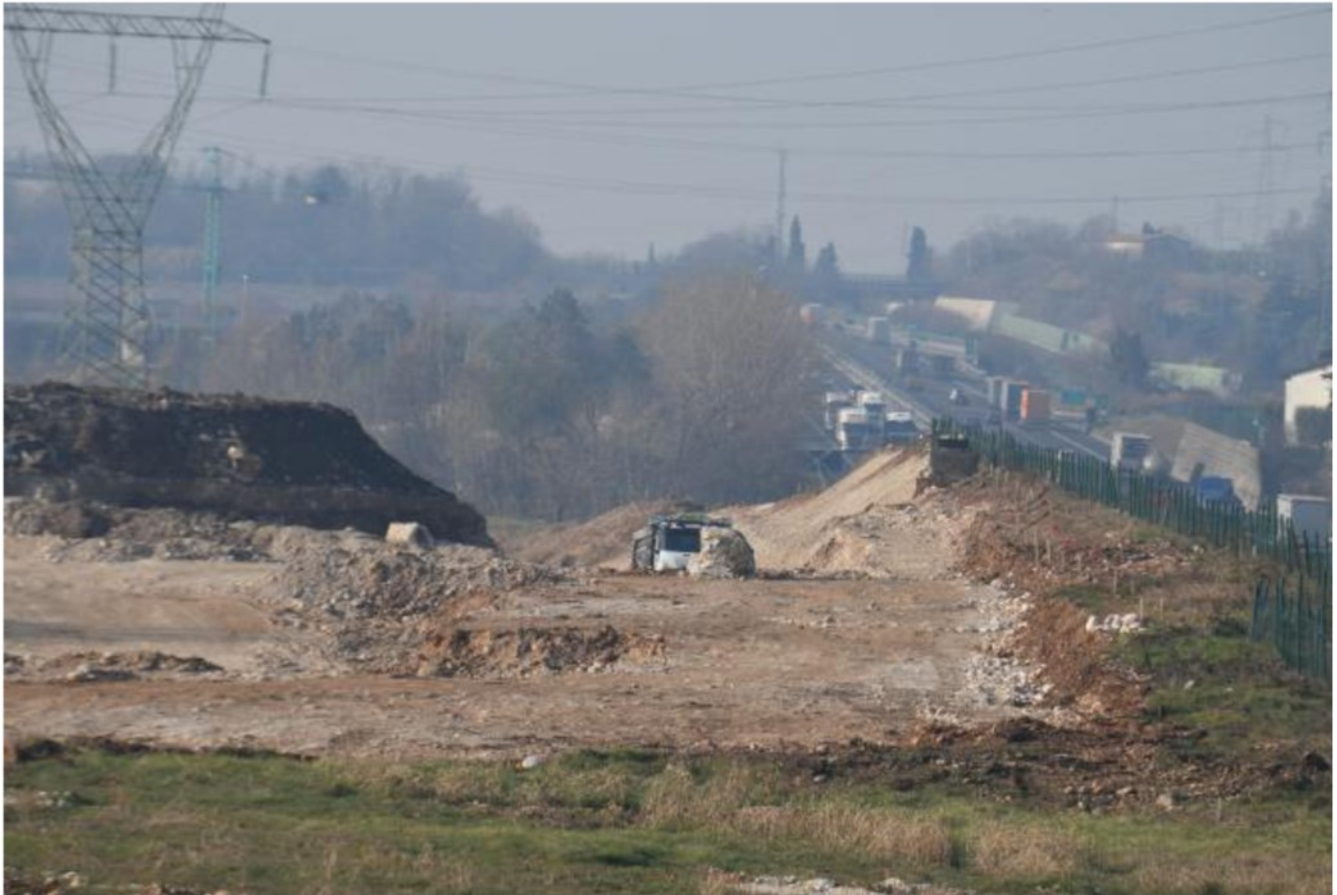
Un cantiere della Tav ferroviaria fra Peschiera e Castelnuovo del Garda FOTO PECORA
